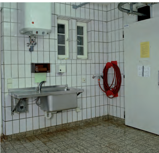
Optimal: Eine Wildkammer mit Warm- und Kaltwasseranschluss
